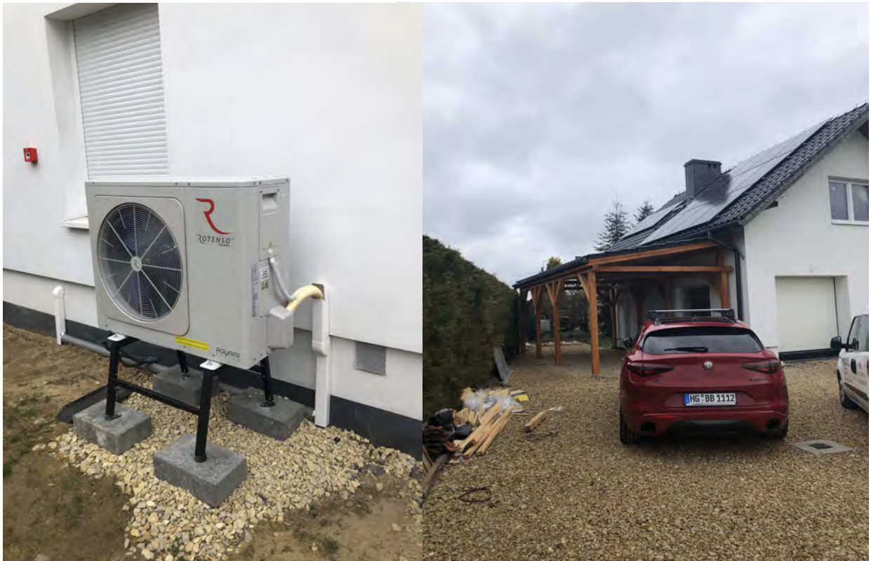
Abb. 8 + 9: Zum ganzheitlichen Konzept gehören auch eine 10 KW Solaranlage und eine Wärmepumpe zum Betreiben der Fußbodenheizung sowie Bereitstellung von Warmwasser. Bei der Installation wurde die Vermeidung von Elektrosmog in den Schlafbereichen sichergestellt.
